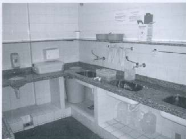
Figura 3 - Expurgo - área destinada exclusivamente à limpeza de artigos
